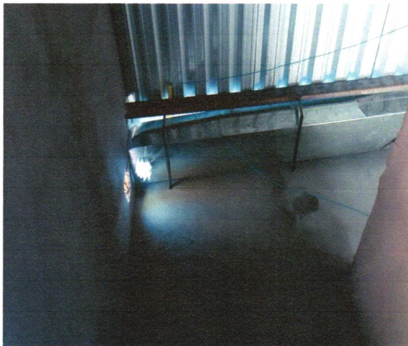
Foto 09 - CALHA EM CHAPA DE AÇO GALVANIZADO NÚMERO 24, DESENVOLVIMENTO DE 100 CM, INCLUSO TRANSPORTE VERTICAL. AF_07/2019
