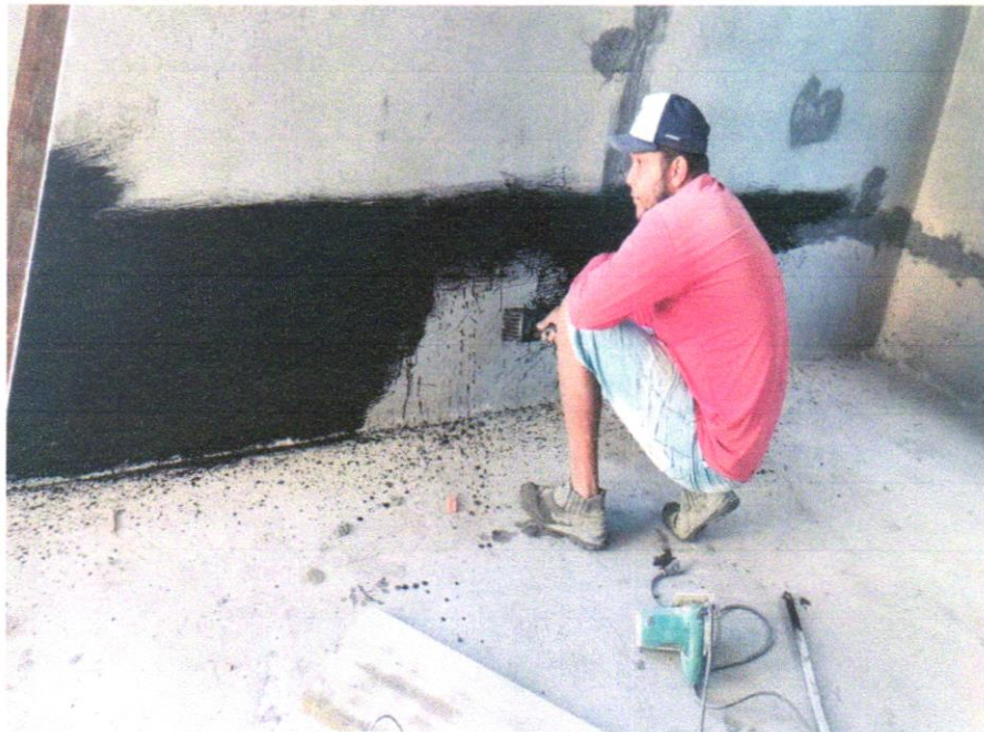
Foto 15 - IMPERMEABILIZAÇÃO DE SUPERFÍCIE COM MANTA ASFÁLTICA, UMA CAMADA, INCLUSIVE APLICAÇÃO DE PRIMER ASFÁLTICO, E=3MM. AF_06/2018
